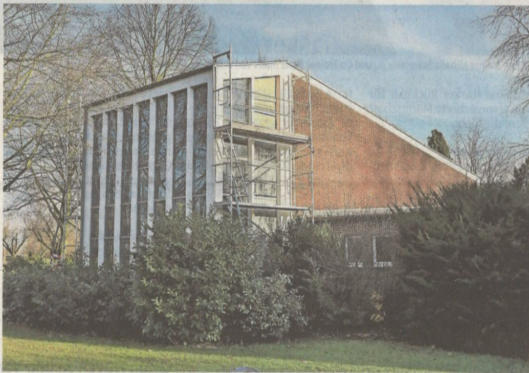
Auch außen müssen die Arbeiten in einer Höhe von bis zu acht Metern durchgeführt werden. Ein Gerüst wurde hier ebenfalls angebracht.
